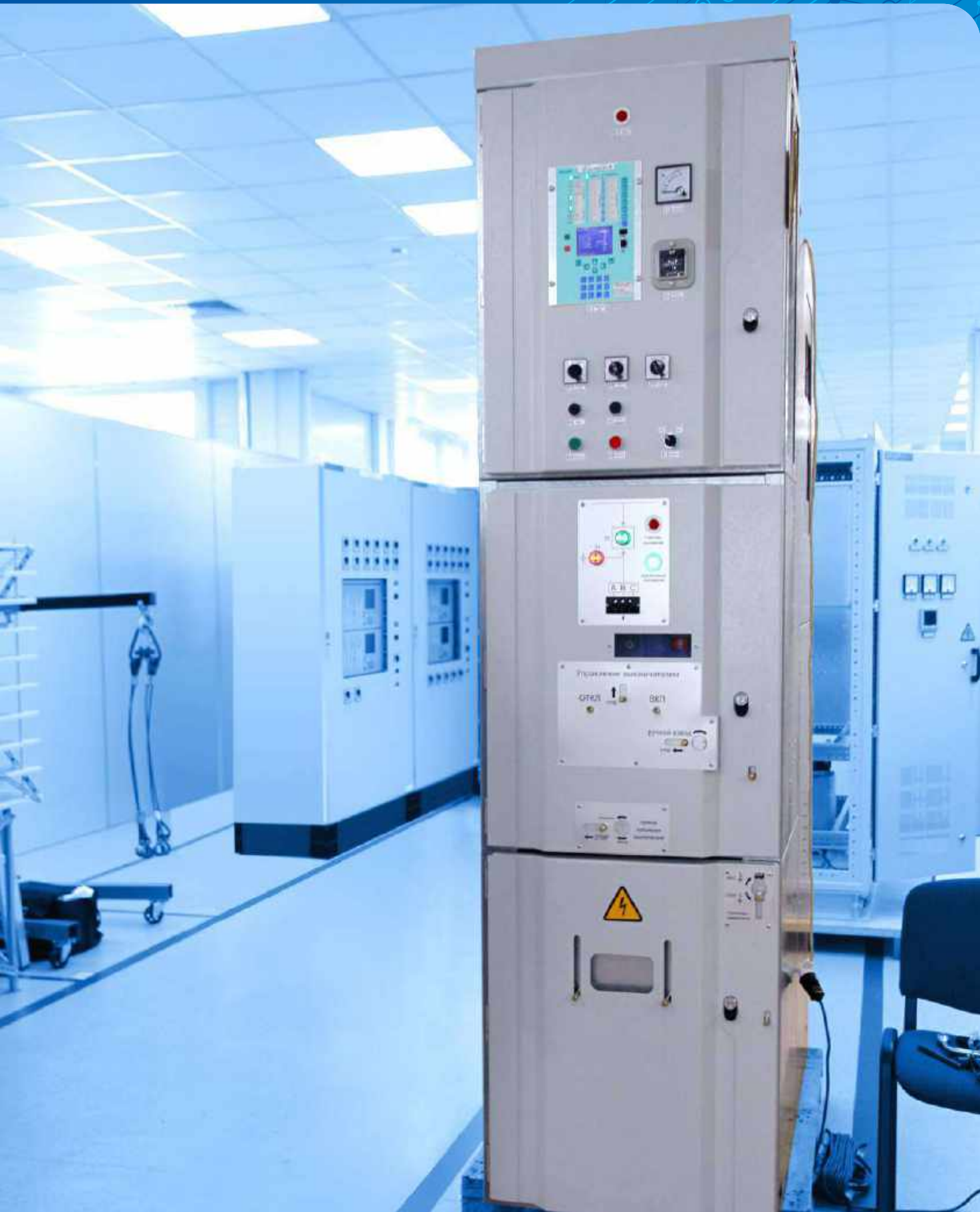
Оборудование среднего напряжения 6, 10 кВ
